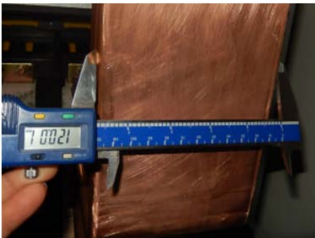
主开关出线母排宽度
