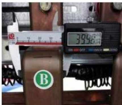
主开关进出线母排 宽度=40mm
