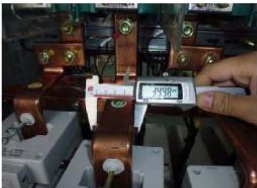
主开关进出线母排 宽度=40mm
