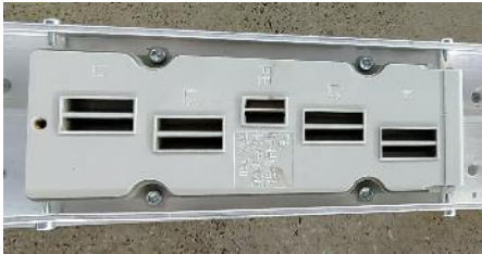
母线槽插接口照片
